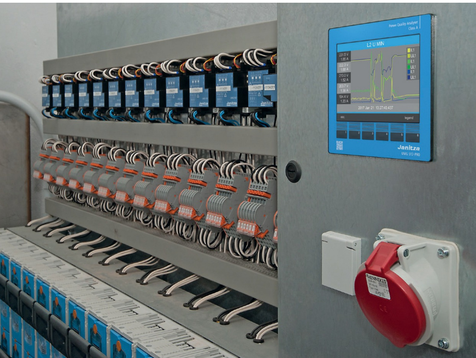
Technologia pomiarowa zainstalowana w stacji transformatorowej z UMG 512-PRO jako urządzeniem nadrzędnym dla urządzeń podrzędnych UMG 103 dla kanałów wychodzących.
