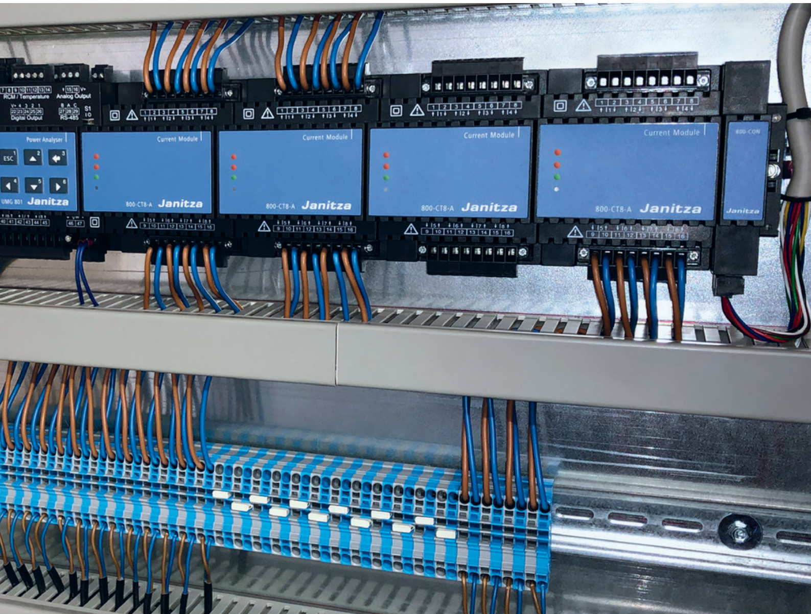
Stacja dystrybucyjna: Transformator pomiarowy wraz ze wszystkimi zasilaczami wychodzącymi (UMG 801 i moduły)
